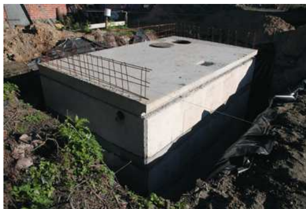
Rys. 2. Zbiornik żelbetowy, prostopadłościenny, górą zamknięty. Na płycie przekrywającej widoczne jest zbrojenie przeznaczone do wykonania muru oporowego ( www.pepebe.pl )
